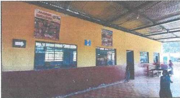
Foto1: Se observa las paredes que necesitan pintura, puertas que se le dará mantenimiento.
