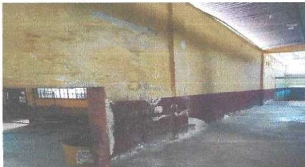
Foto 3: Se observa el desprendimiento de pintura en paredes, en los módulos 1, 2 y 3
