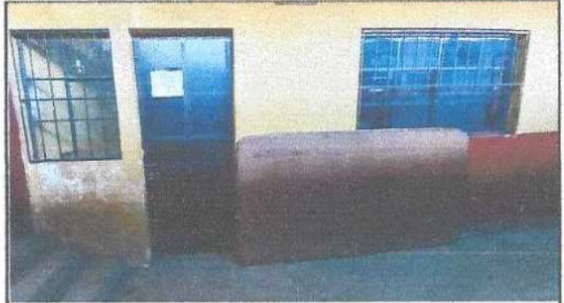
Foto 2: Se observa el deterioro de pintura en paredes y puerta que necesita mantenimiento.
